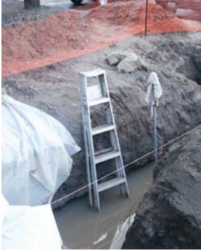
Vías de Evacuación inadecuadas, Agua y falta de Protecciones
