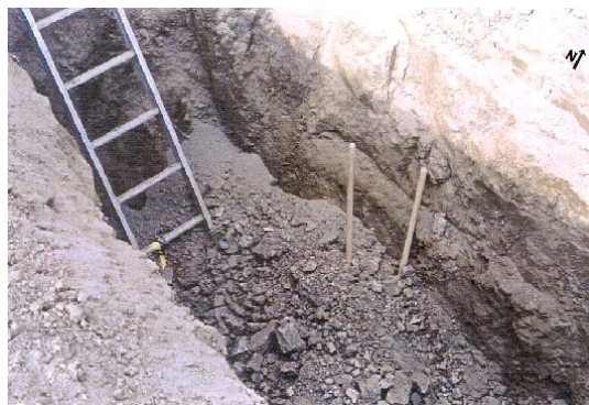
Falta de Protecciones, Derrumbes
