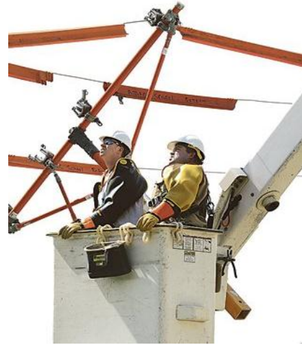
Protección de la Líneas Eléctricas
