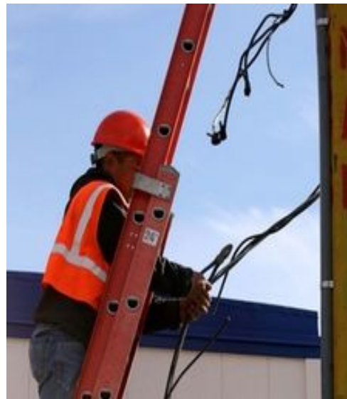
Uso De Escalas Cerca de Líneas Eléctricas
