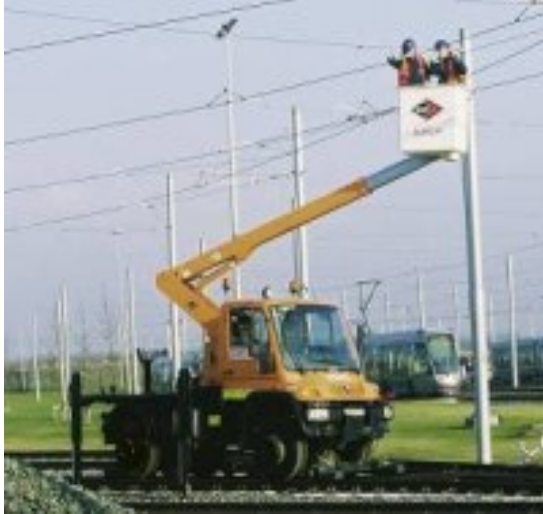
Trabajando Cerca de las Líneas Eléctricas
